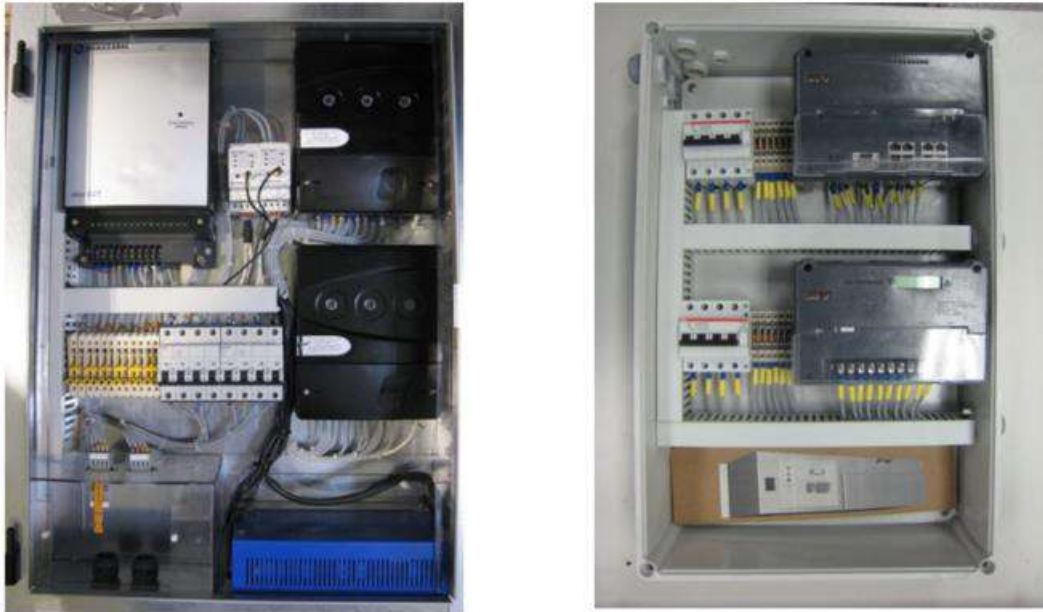
Figura 18. Ejemplo de equipos colocados en un Centro de Transformación.
