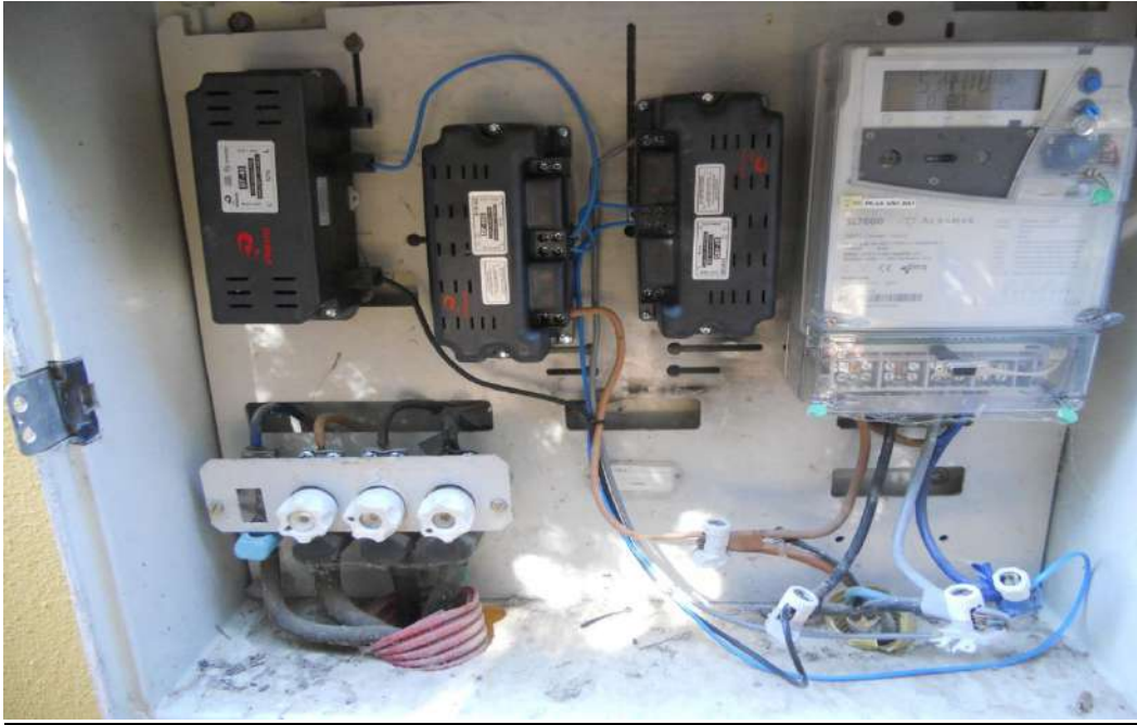
Figura 60. Filtros colocados en paralelo dentro del cuadro general de protecciones.
