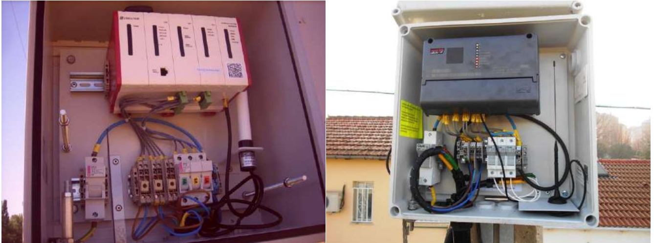
Figura 38. Ejemplo de dos equipos TGB de las marcas Circutor y ZIV, respectivamente.
