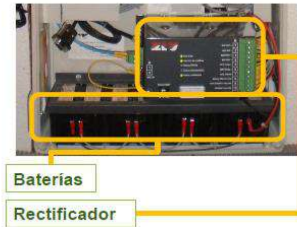
Figura 42. Rectificador de baterías dentro de un armario STAR.
