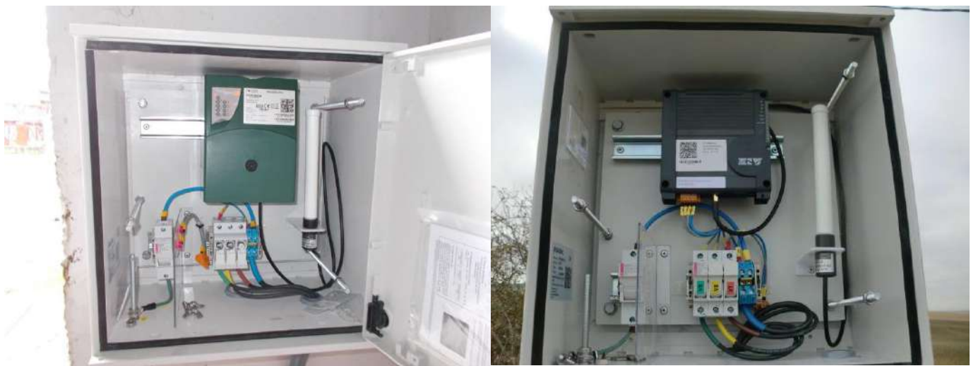
Figura 39. Ejemplo de dos equipos GTP de las marcas Teldat y ZIV, respectivamente.
